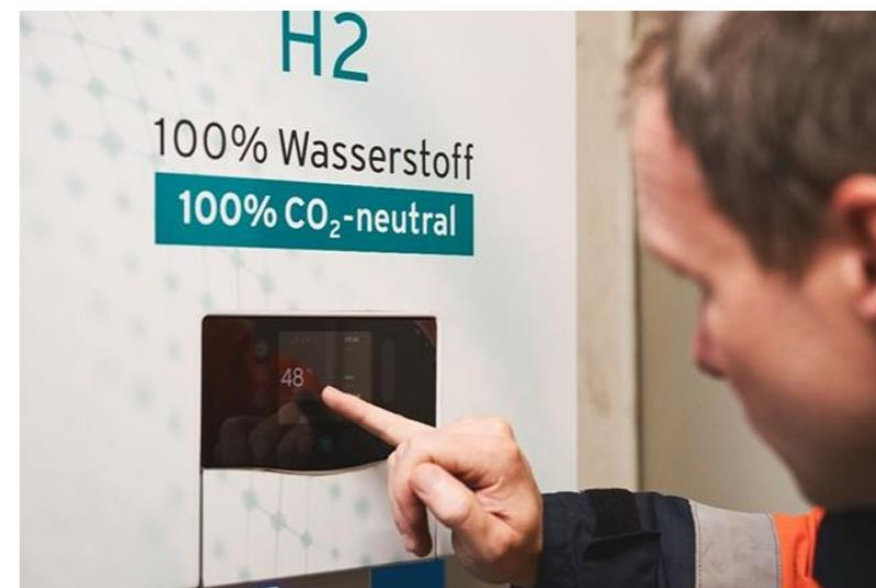
Auf Temperatur mit Wasserstoff: Eine der neuen 100%-H2-Brennwertthermen geht in Hohenwart Betrieb. Foto: Jost Listemann/Zukunft Gas
