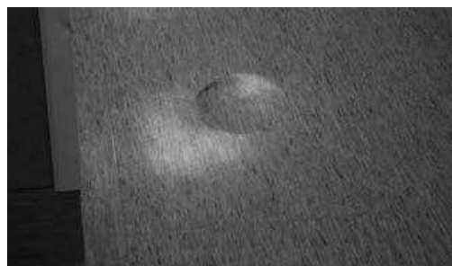
Figura 159. Sfondamento del massetto sotto la pavimentazione in corrispondenza del passaggio di tubazioni.
