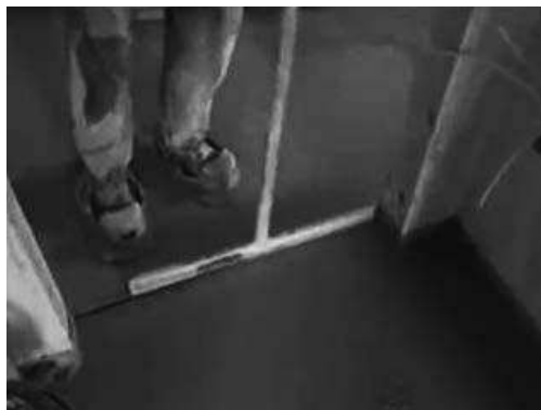
Figura 108. Interruzione del massetto nella soglia.
