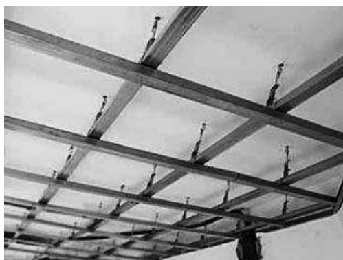
Figura I 32. Struttura metallica di sostegno.
