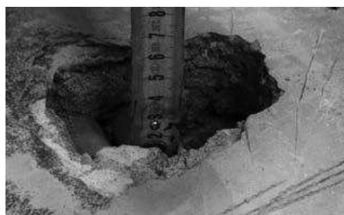
Figura 160. Spessore inadeguato di massetto sopra le tubazioni (< 2,5 cm).
