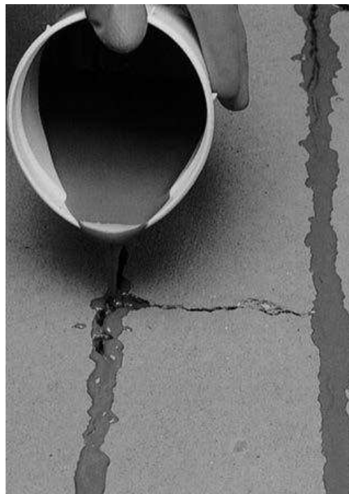
Figura 158. Fessurazioni nel massetto (Fonte: Mapei).
