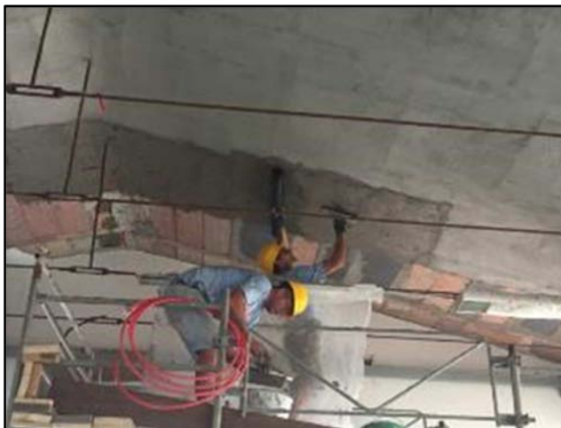
Figura 2.19 – Rinforzo di solaio (antifondellamento) con rete di fibra di vetro AR e malta.
