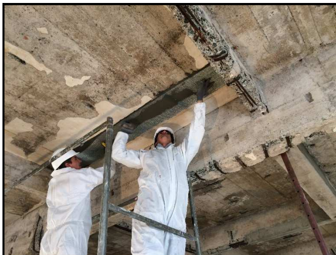
Figura 2.11 – Rinforzo a flessione di trave mediante placcaggio con strisce di tessuto unidirezionale realizzate con rete di acciaio galvanizzato ad altissima resistenza e malta cementizia.
