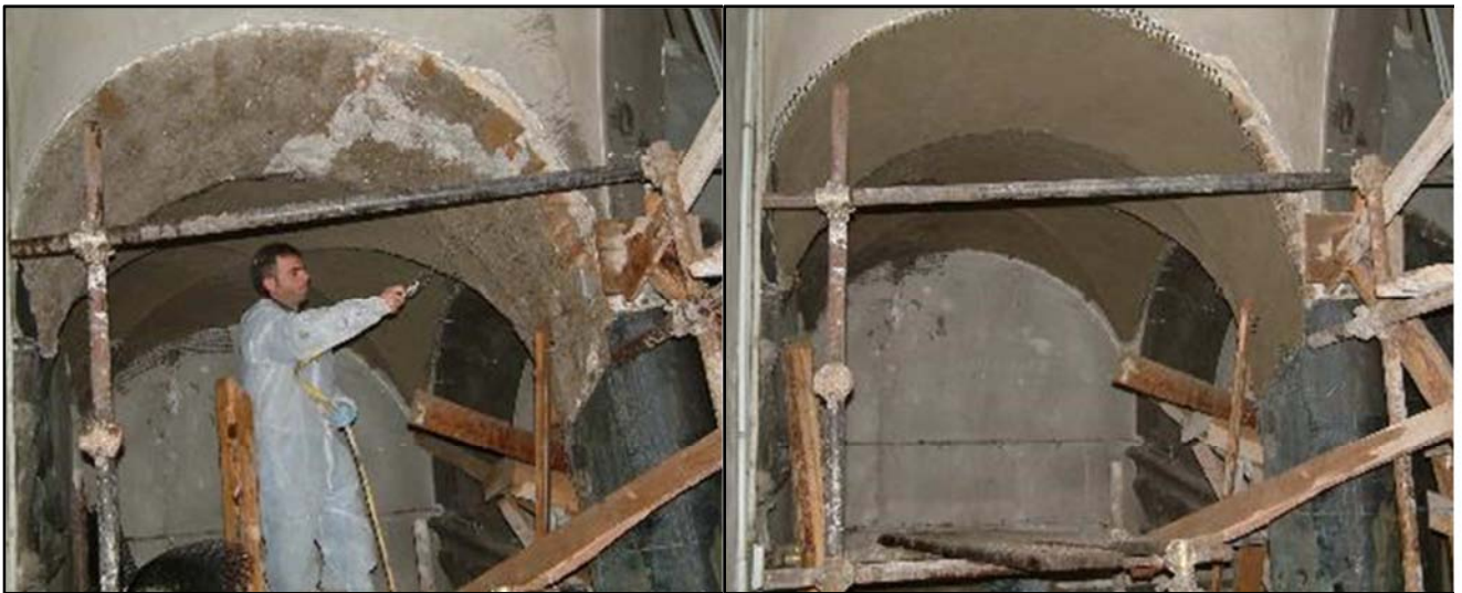
Figura 2.5 – Rinforzo intradossale di volta muraria con rete di fibra di vetro AR e malta.
