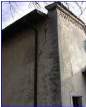
Ribaltamento della facciata
